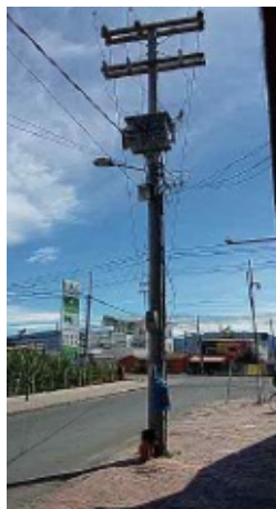
Figura 3. Subestación tipo aéreo
