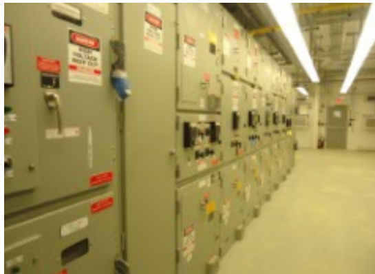
Figura 1. Subestación media tensión tipo interior
