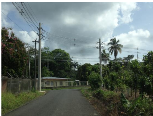
Figura 7, Línea de distribución.
