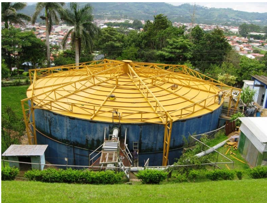
Ilustración 7. Vista de Estructura de techo, tanque de Tremedal, San Ramón Fuente: Ing. Pamela Ramírez 10-07-2009
