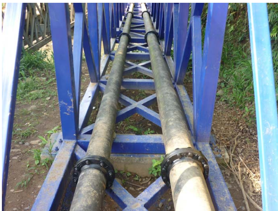
Ilustración 6. Tubería instalada a través de la estructura de soporte Fuente: Autor. 06-07-2011
