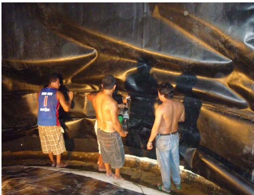
Ilustración 4. Colocación de la membrana de polietileno en el interior del tanque Fuente: Autor. 03-09-2009
