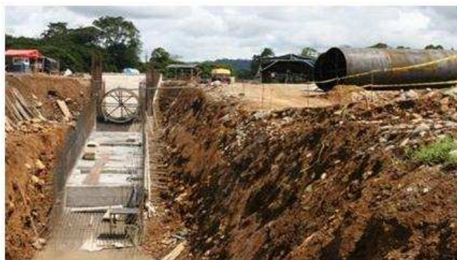
Tubería de presión
